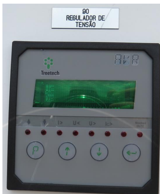
Relé regulador de tensão existente no transformador
