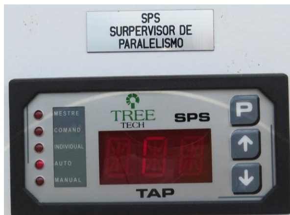
Relé supervisor de paralelismo existente no transformador.
