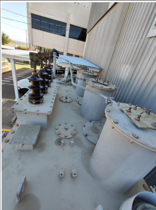
Foto 5 – Vista superior do transformador
