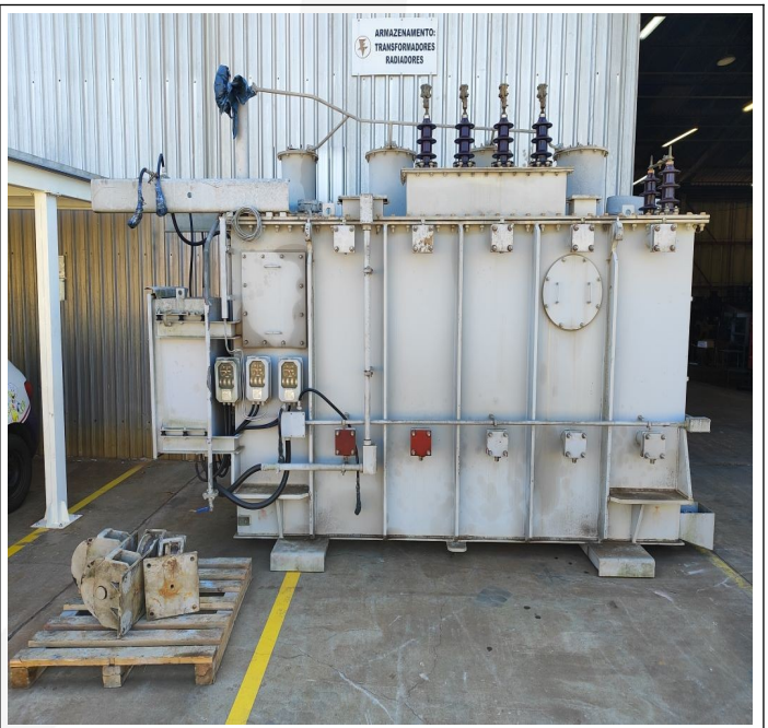
Foto 4 – Vista frontal do transformador
