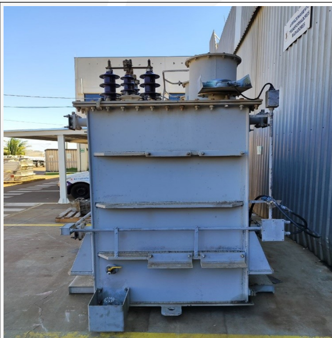
Foto 3 – Vista lateral do transformador
