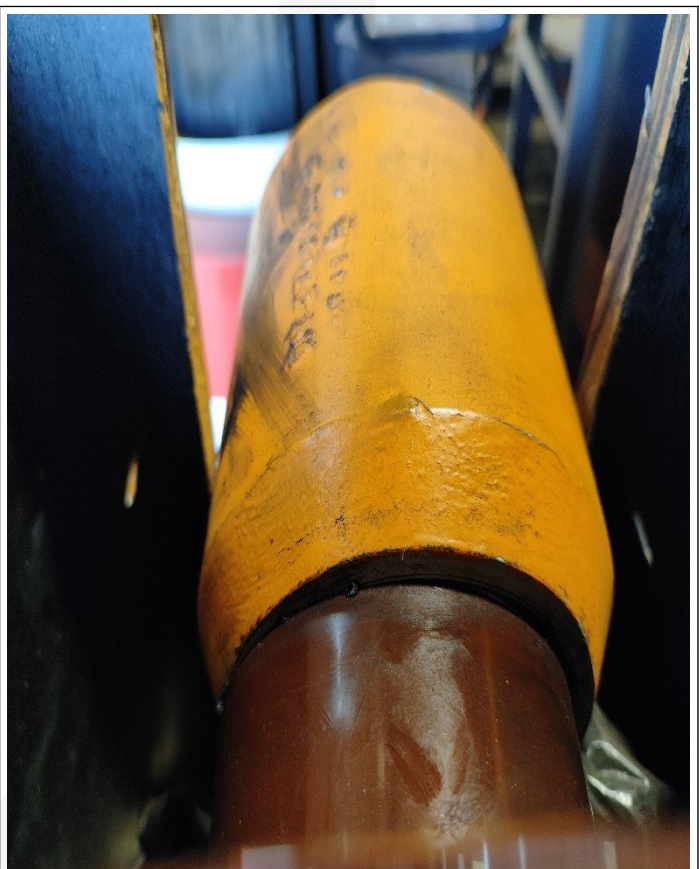
Foto 10 – Bucha com deslocamento
