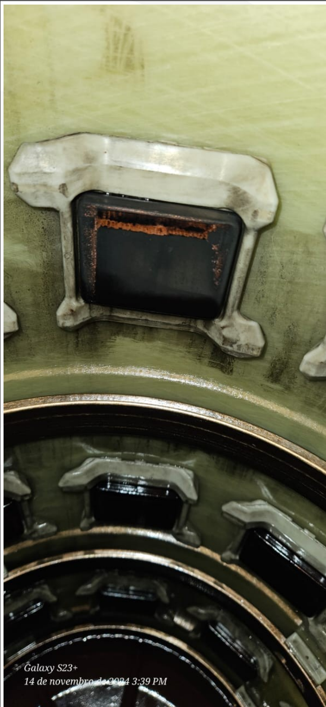
Foto 17 – Comutador com desgaste
