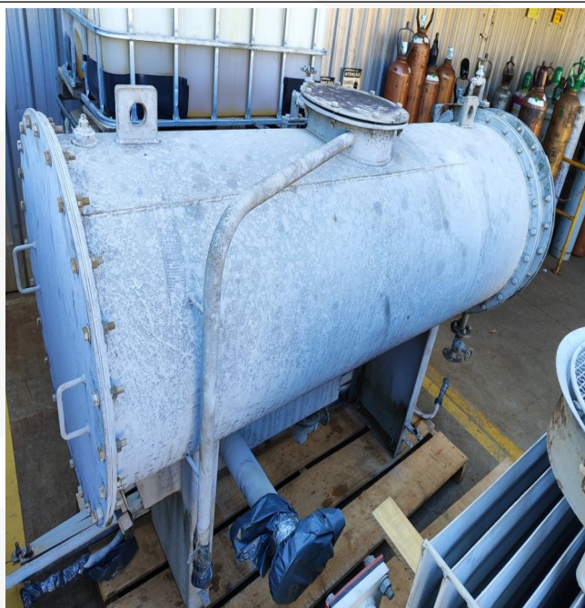
Foto 7 – Tanque de expansão
