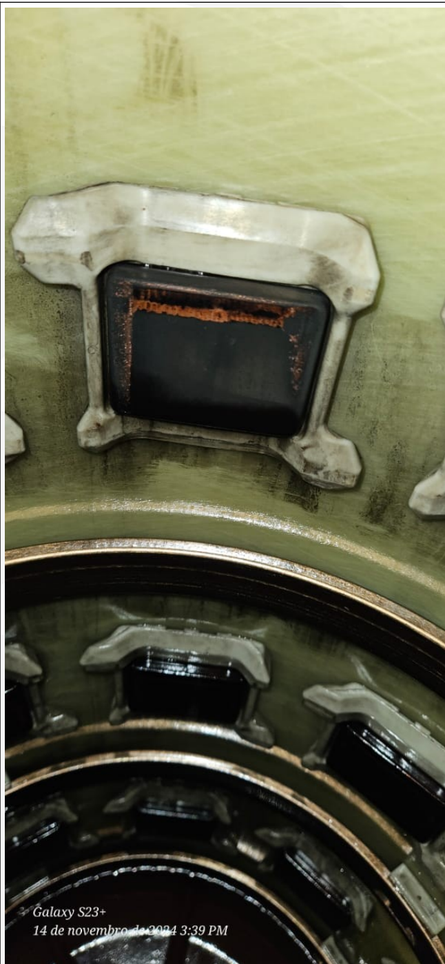
Foto 13 – Comutador com desgastes
