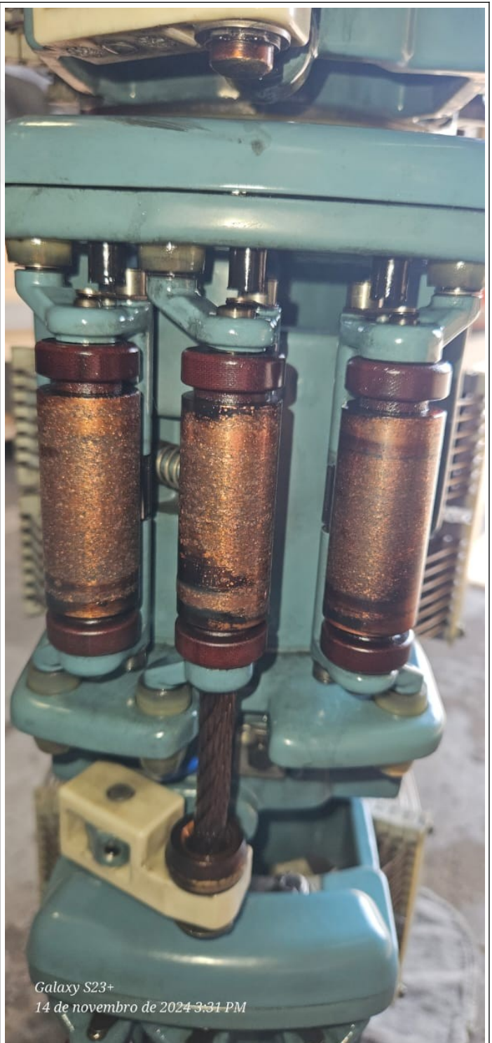
Foto 16 – desgastes nos contatos
