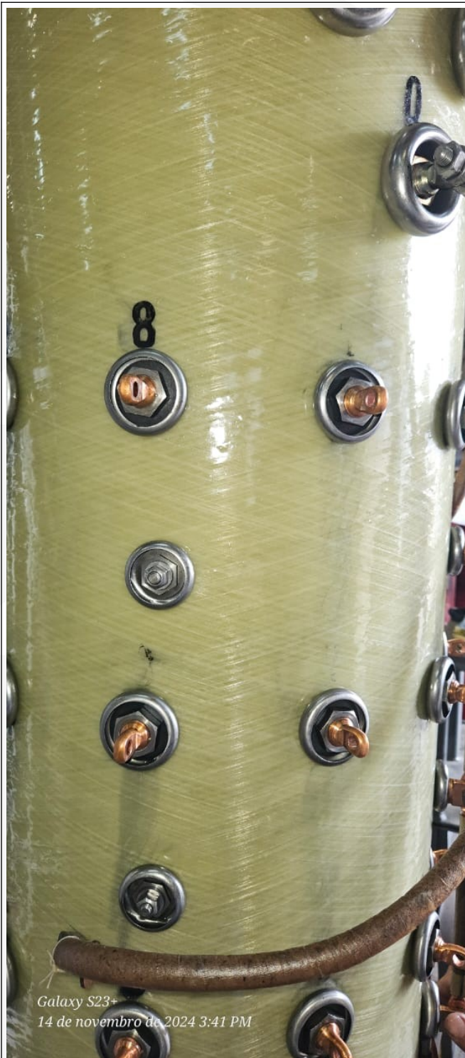
Foto 15 – Comutador sob carga
