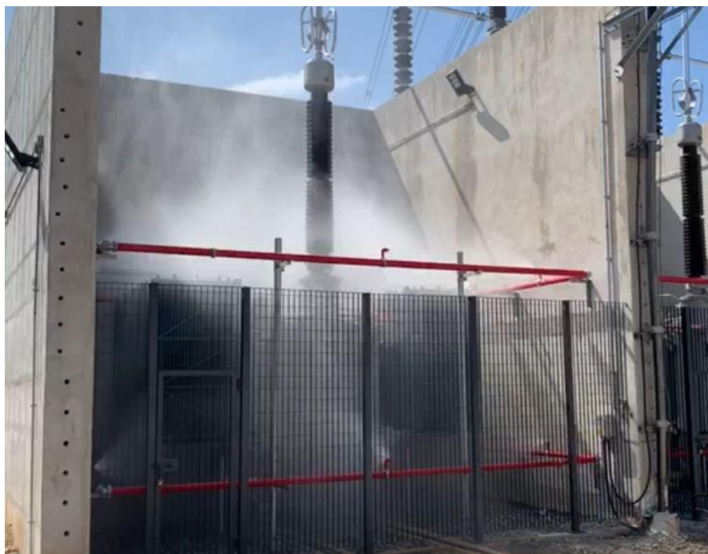
Subestação Piratininga – São Paulo/SP
